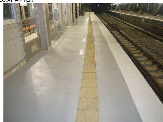
駅ホームの笠石を含む舗装改良 駅ホームの嵩上げに適用可能
