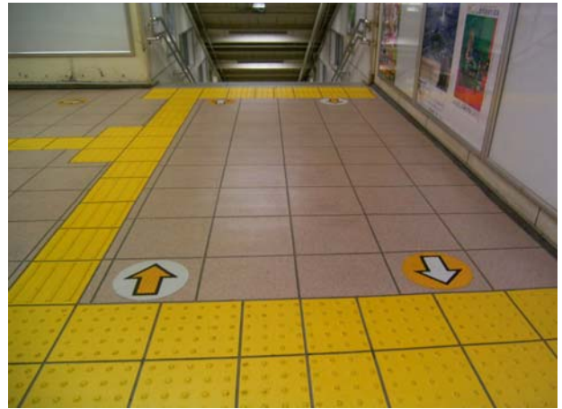
駅コンコース Option目地入れ施工 KC工法(塗床)同時施工
