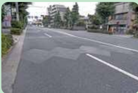
道路の 打継ぎ段差 の解消・ 轍掘解消
