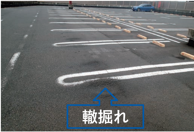
駐車場内轍掘れ
